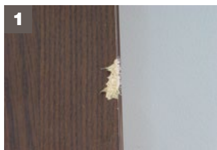
1 Příprava povrchu před opravou. Nutno očistit a odstranit volné části.
